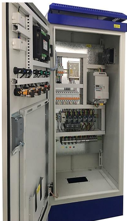
恒压供水控制柜内部照片
