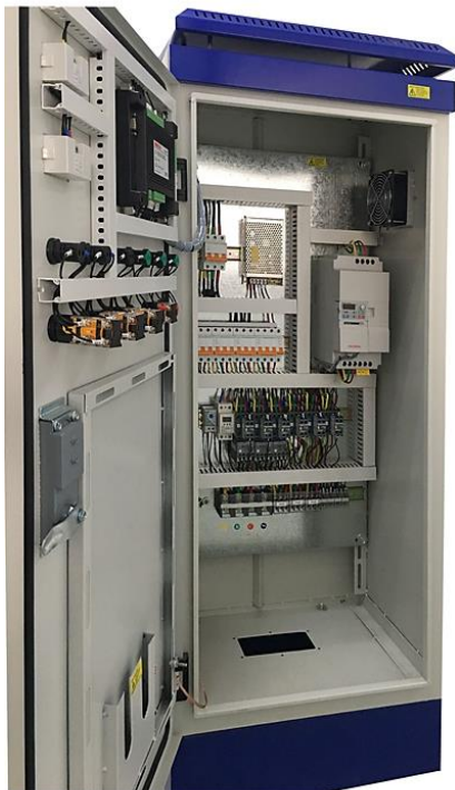
恒压供水控制柜内部照片
